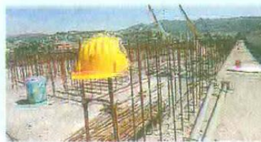
UN CANTIERE RIMASTO A METÀ
